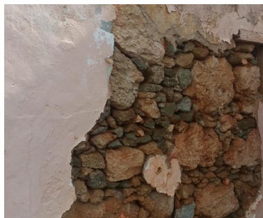
Figuur 6: Schadeplek op historische wand. Foto Coen van der Spek.
